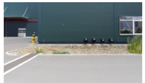
Das anfallende Wasser des 20.000 qm großen Flachdachs wird ebenfalls über die BIRCOsir-Rinnen auf dem Gelände in die Versickerungsmulden geführt
